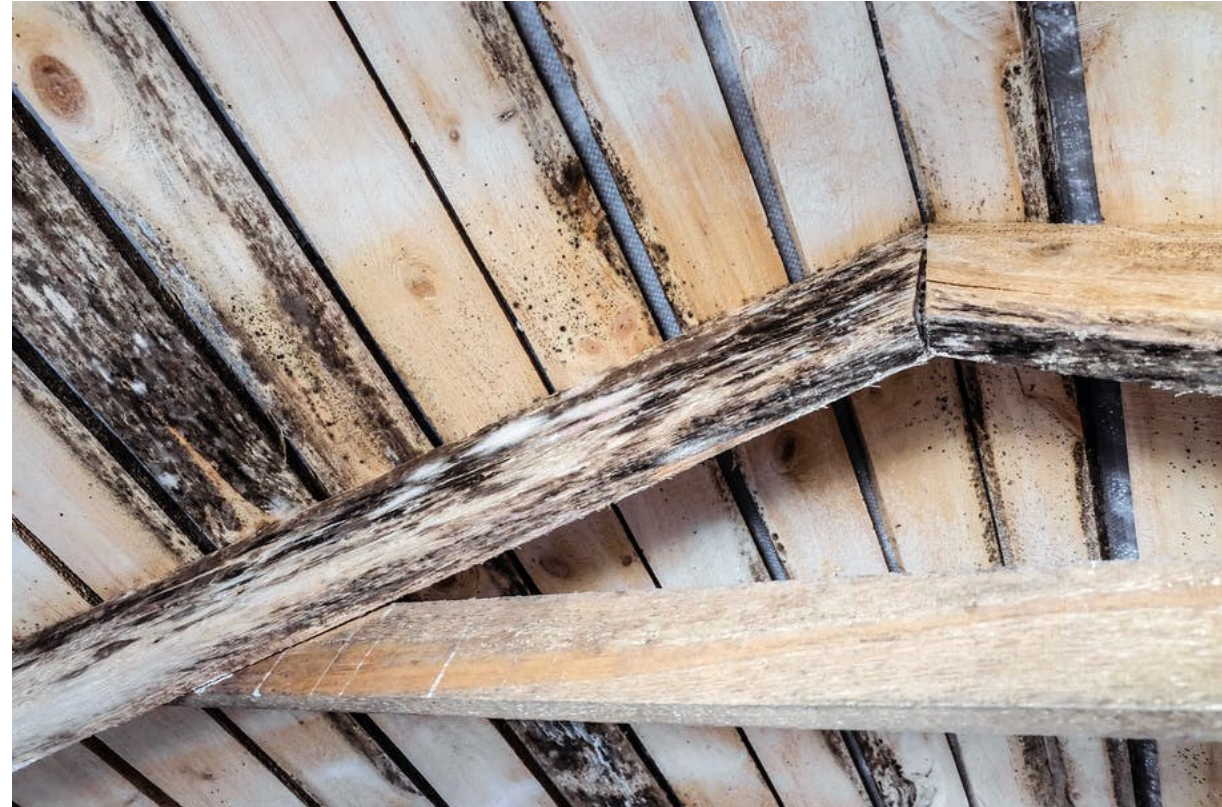
Starker Schimmelbefall und nicht reparabile Schäden einer Dachkonstruktion
